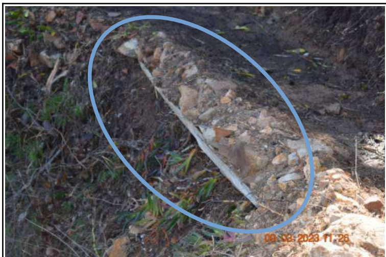
Autre vue de l'instabilité actuelle du terrain.
